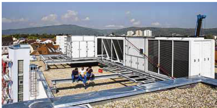
Eine komplexe Anlage: Die Wärme- und Kältezentrale auf dem Dach des Gebäudes hat eine Gesamtleistung von 1000 kW.
