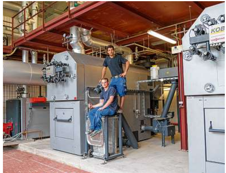
Die neue Heizzentrale der Reha-Klinik Wehrawald. Im Bild die beiden Mitarbeiter, Azubi Jonas Villingner und Bauleiter Matthias Baumgartner. BILDER: THT
