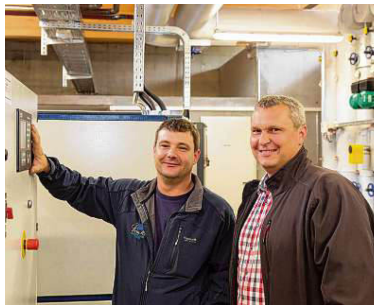
Daniel Peick, von Tröndle Haustechnik, und Andreas Schillinger von den Stadtwerken Waldshut-Tiengen in der neuen Heiztechnikzentrale im Schulzentrum in Tiengen. BILD: THT
