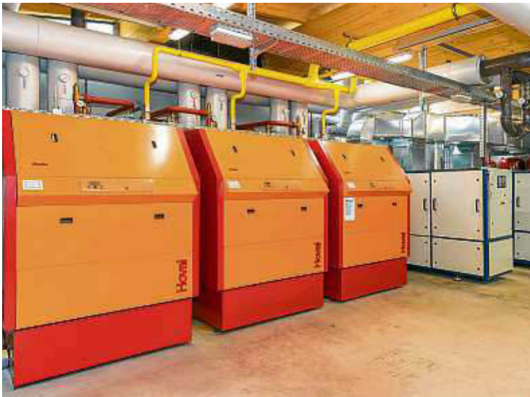
Die Heizzentrale im Tiengener Schulzentrum mit den drei BKH-Modulen. Angeschlossen ist neben den Schulen unter anderem die Stadthalle.
