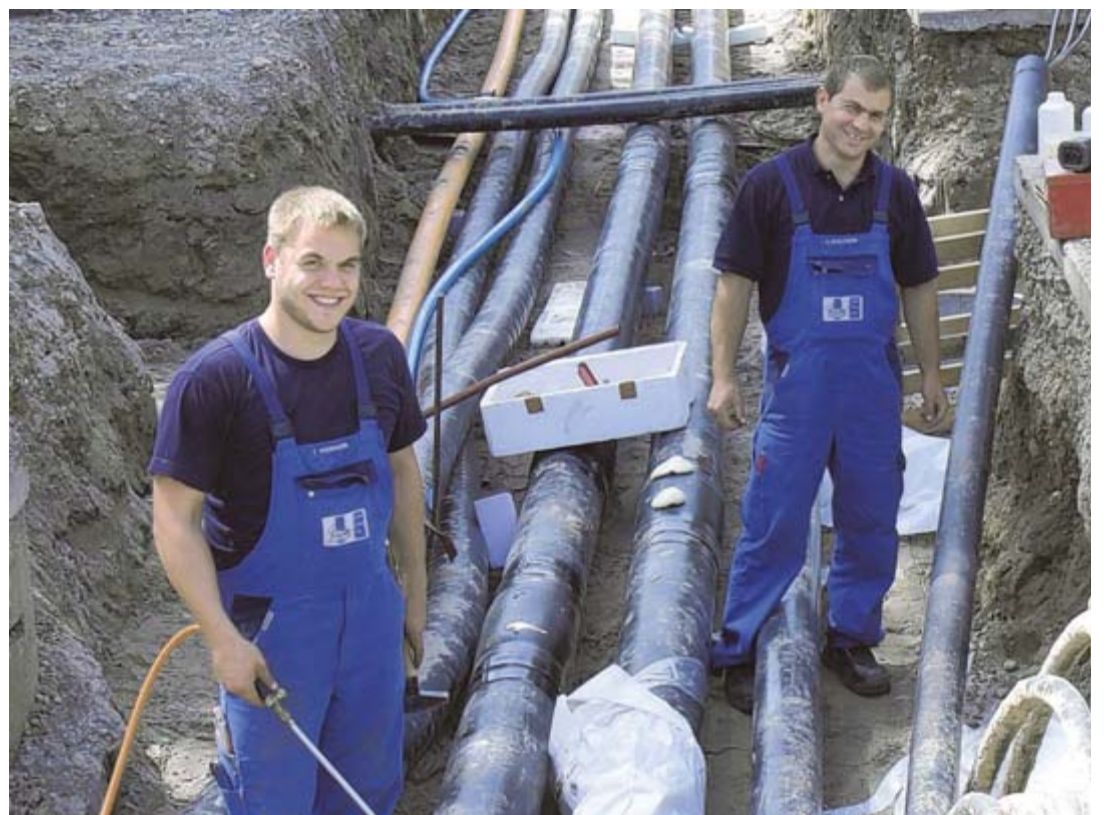
Tröndle Haustechnik geht für seine Auftraggeber auch unter die Erde: Hier beim Verlegen der Leitungen für den Nahwärmeverbund im Schulzentrum Tiengen.
