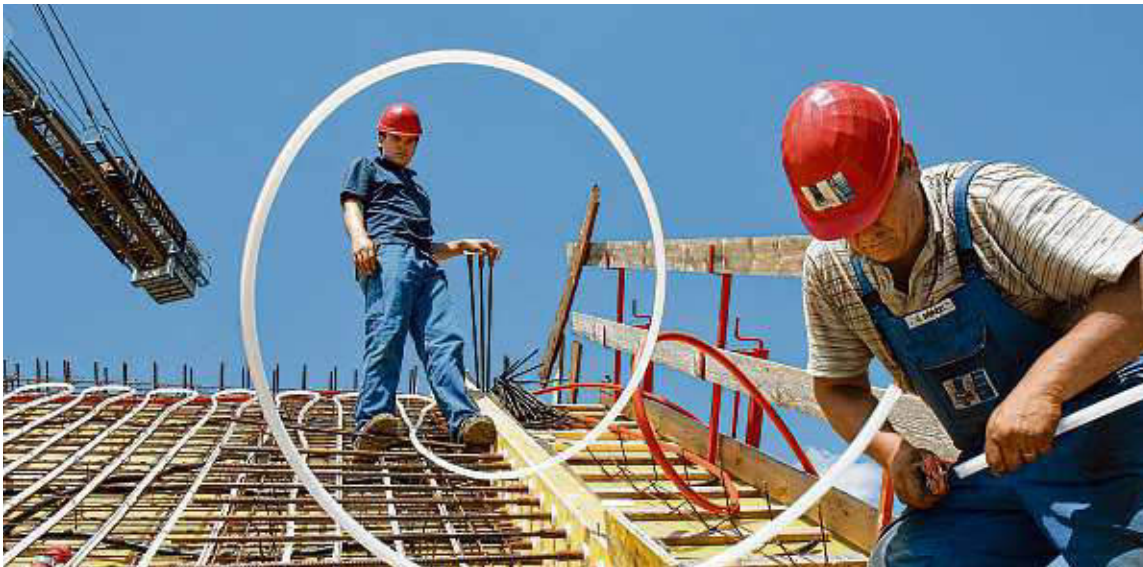
In den Dachflächen des futuristischen Gebäudes von Vitra in Weil wurden 15 000 Meter Kunststoffrohre zum Heizen und Kühlen verlegt. BILDER: TRÖNDLE HAUSTECHNIK
