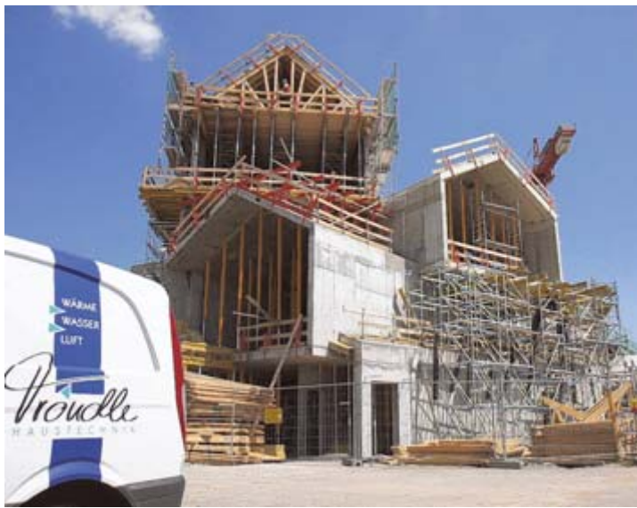
Das Vitra-Haus in Weil am Rhein wird mit von Tröndle Haustechnik gebauten Anlagen geheizt, gekühlt, entlüftet und befeuchtet.
